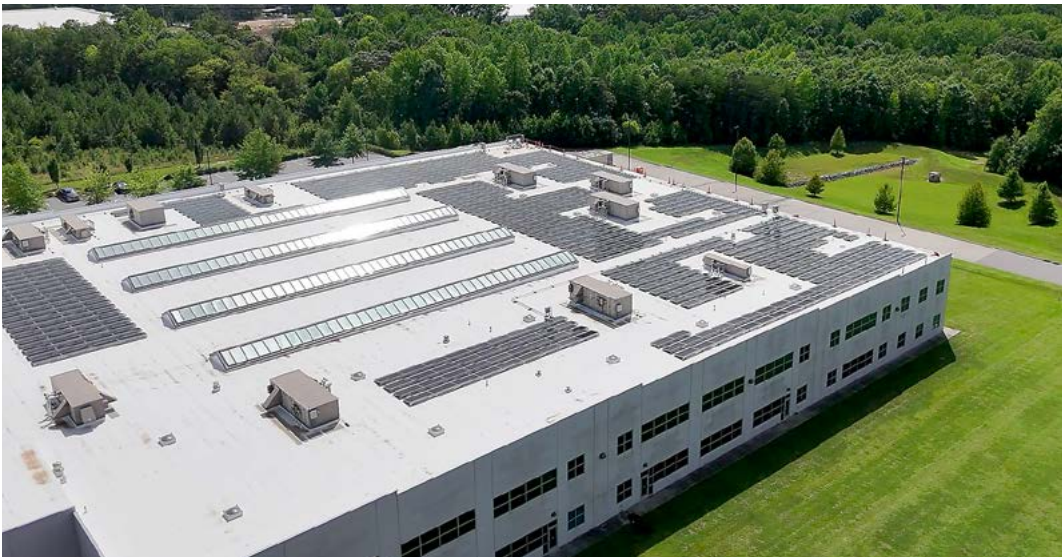
Photovoltaikanlage von Bürkert Huntersville (USA)
